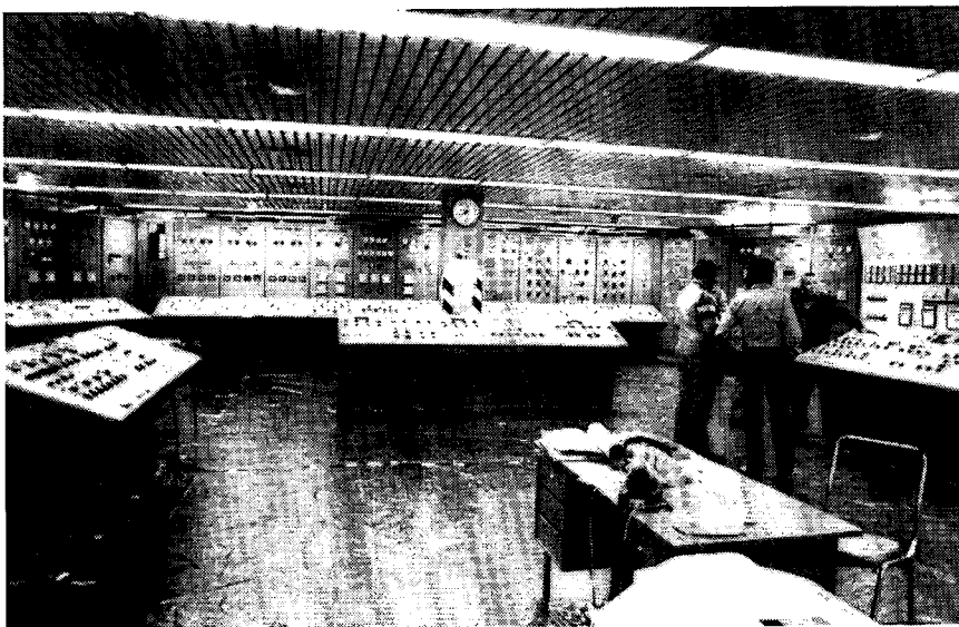
Sala de comando en la Central Térmica "Güemes".
